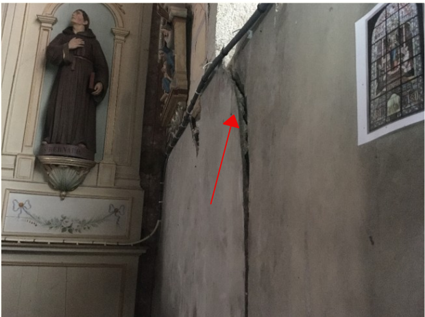
Transept sud - Décollement de l'enduit avec risque important de chute
