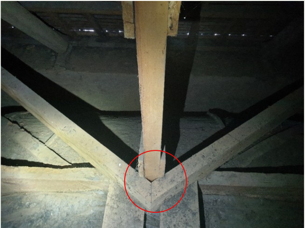
Croupes - Réparation triangulation insuffisant, assemblage fragile
