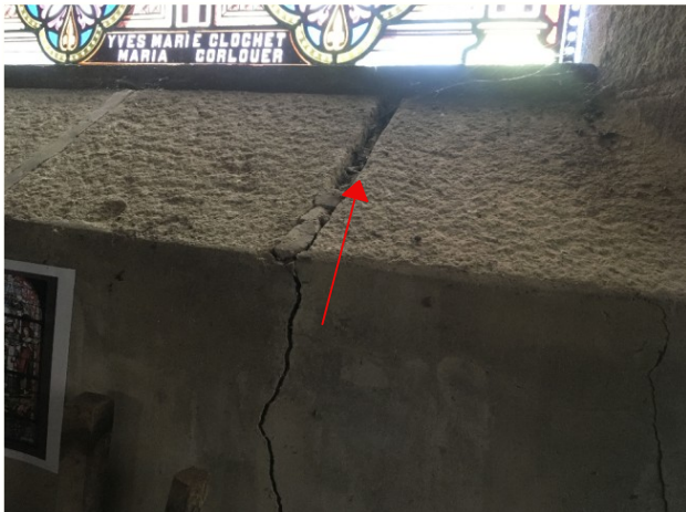
Bas-côté sud - Joint creux aggravé par une fissure
