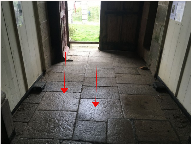
Clocher - Humidité avec zone de rétention d'eau
