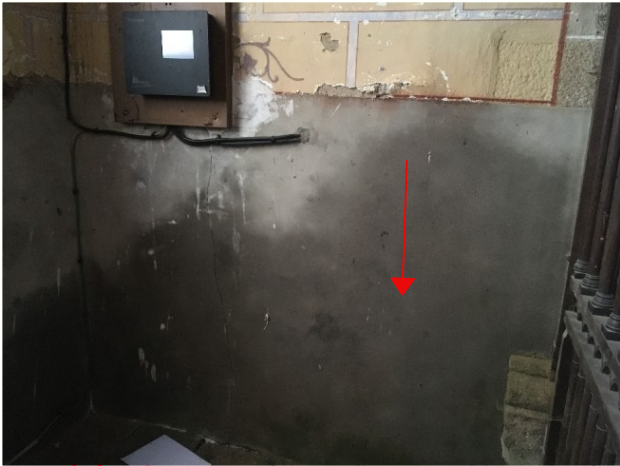
Bas-côté sud - Remontées capillaires visibles en intérieur
