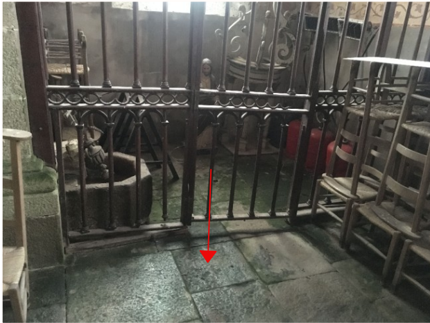
Narthex nord - Verdissement très important du dallage
