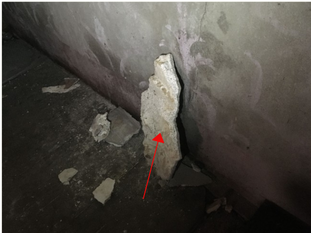
Transept sud - Chute d'enduit
