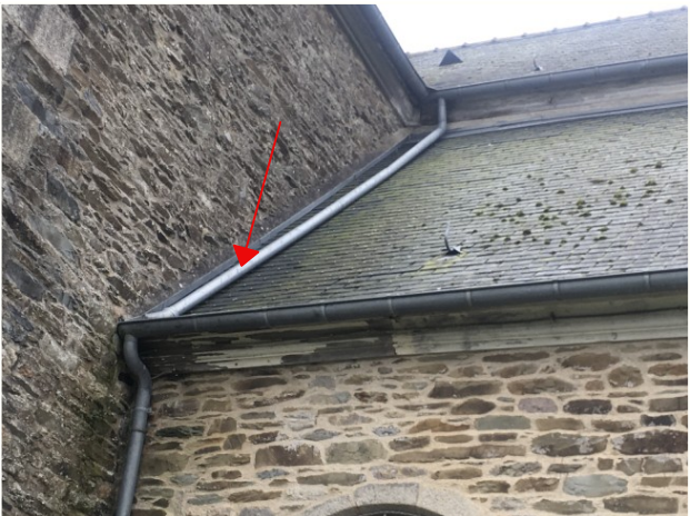
Élévation sud - Sous dimensionnement des descentes
