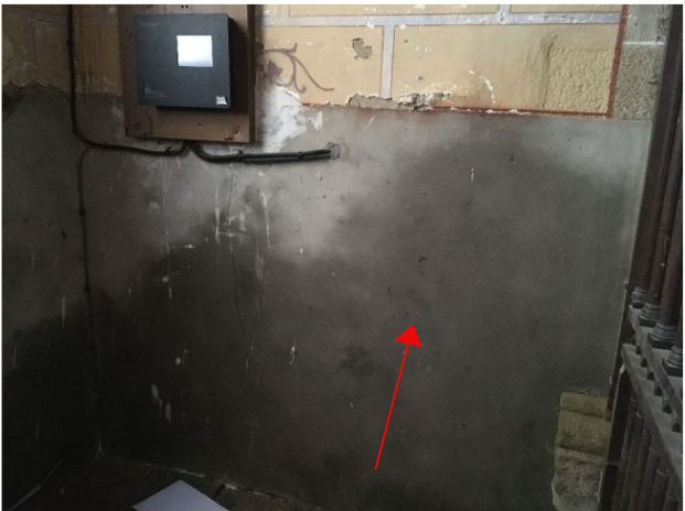
Bas-côté sud - Humidité par remontées capillaires
