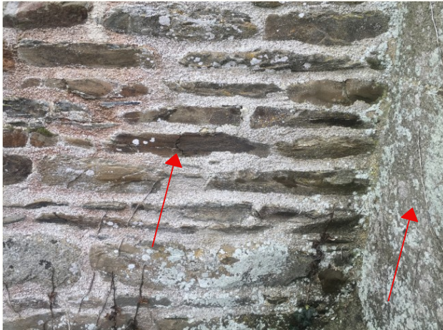
Élevation est - Pierre fissurée & colonisation végétale
