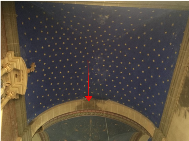
Croisée du transept - Décollement des enduits
