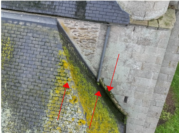
Bas-côté nord - Ecoulement des eaux sur solin
