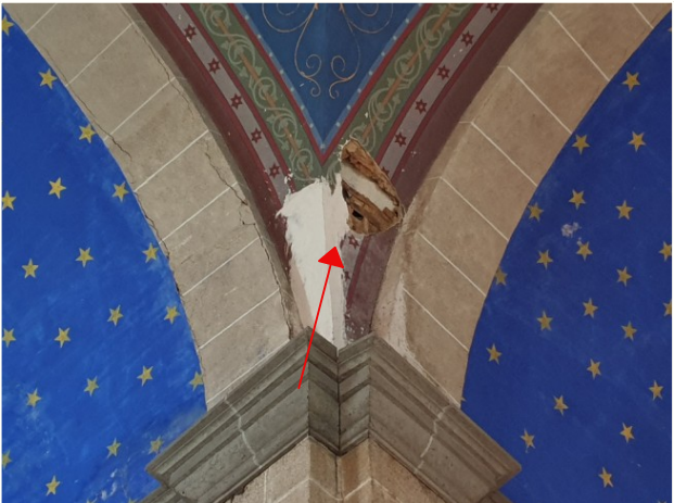
Croisée du transept - Exemple de désordres en intérieur due aux infiltrations d'eau
