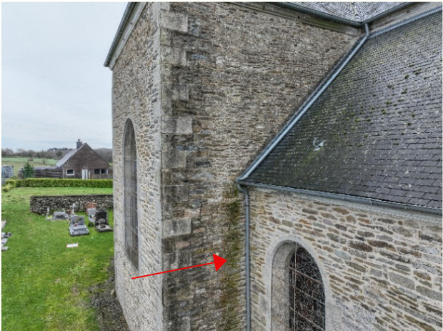
Élévation sud - Ecoulement des eaux sur maçonneries
