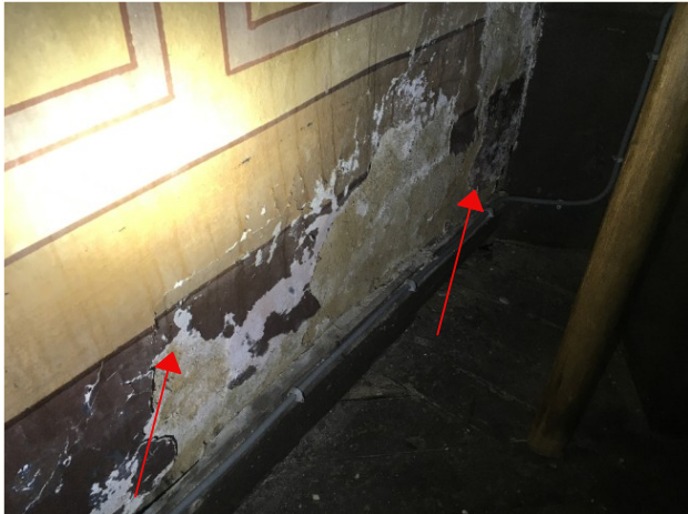
Choeur - Enduit endommagé
