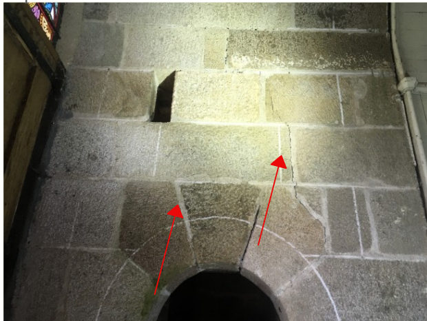
P04 - Déchaussement de pierre et fissuration en contact
