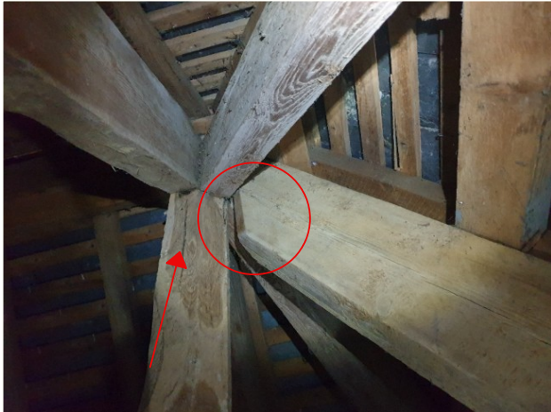
Croupes - Infiltration, réparation triangulation assemblage insuffisant
