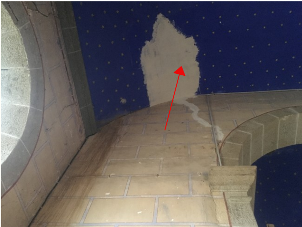
Bas-côté nord - Reprise sur voute et fissure
