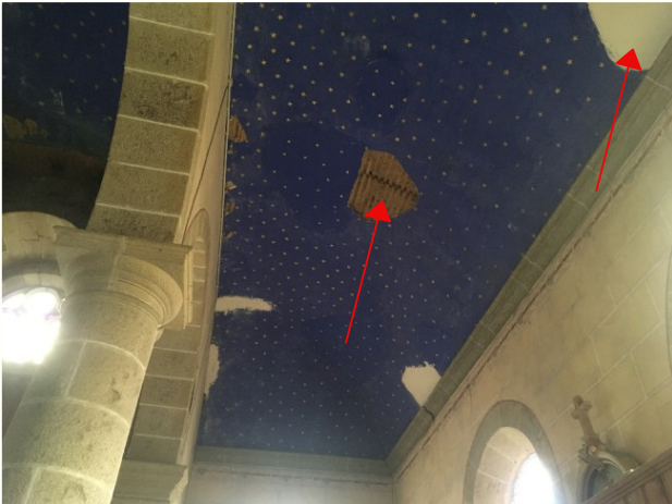
Bas-côté nord - Reprise et chute de voute
