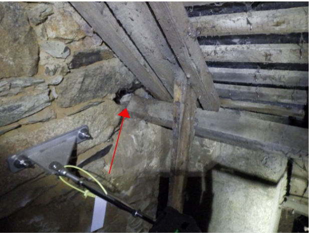
Nef - Panne suspendue, instabilité
