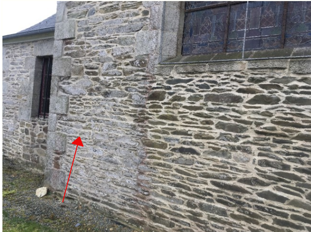
Élévation nord - Colonisation végétale
