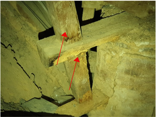
Croisée - infiltration eau, aubier
