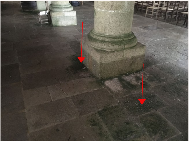
Bas-côté nord - Humidité avec trace de champignon ?
