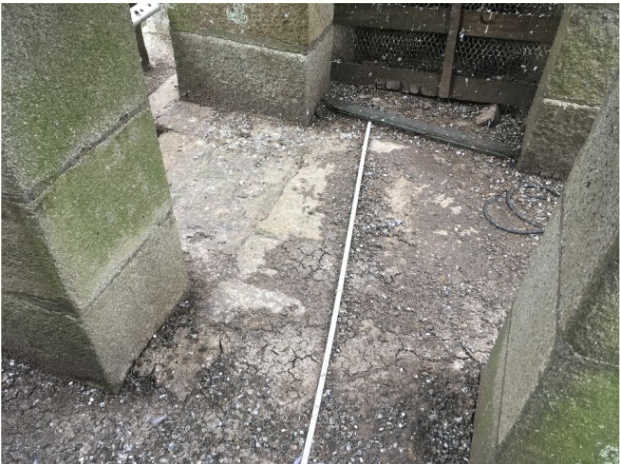
Clocher - Terrasse, zone d'infiltration d'eau
