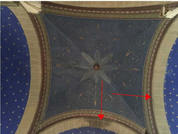
Croisée du transept - Humidité et fissure sur voûte
