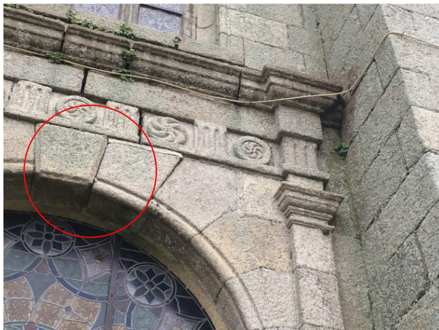
Clocher - Affaissement du claveau
