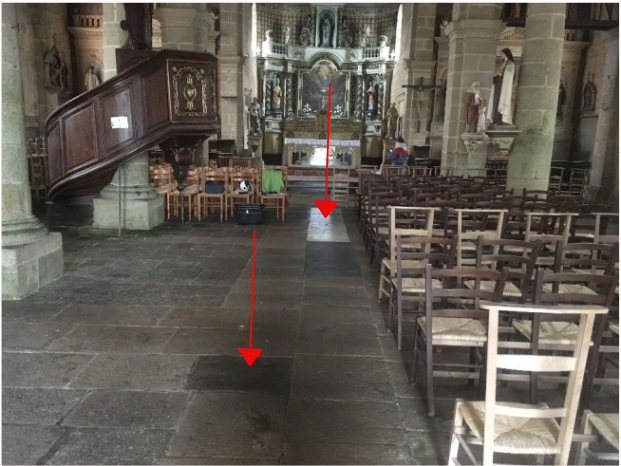
Nef - Humidité et présence de dalles funéraires
