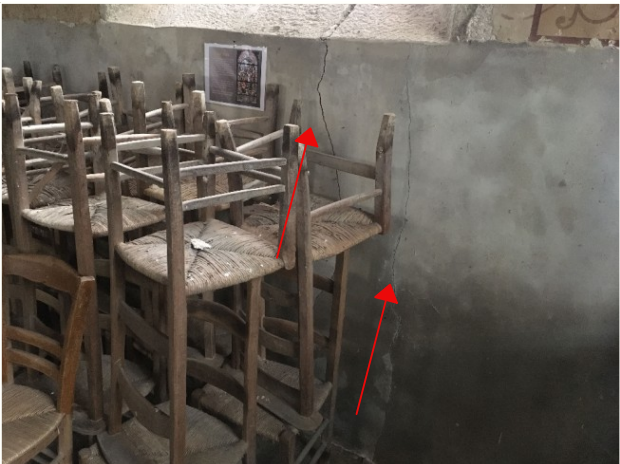
Bas-côté sud - Fissuration en abord de baie
