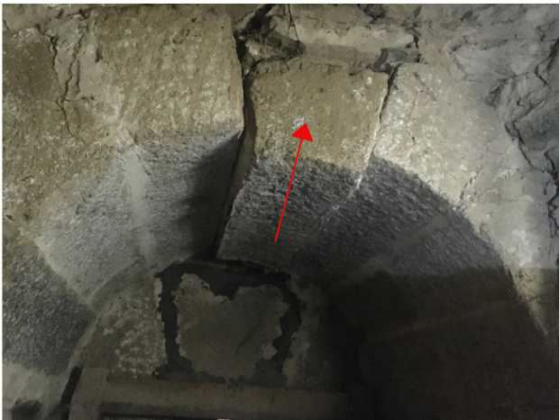
P04 - Déchaussement important de la clé de voute de la porte
