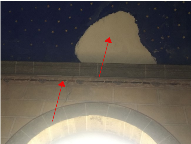
Bas-côté sud - Reprise sur voûte et fissure en contact
