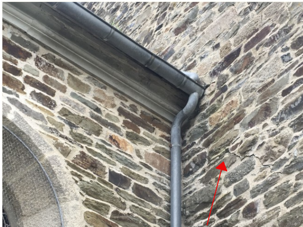
Élévation sud - Fissure
