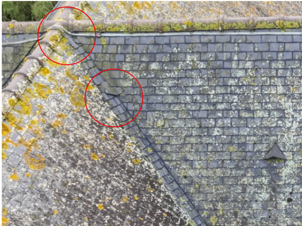
Noues - Désordre, entrées d'eau par les noues
