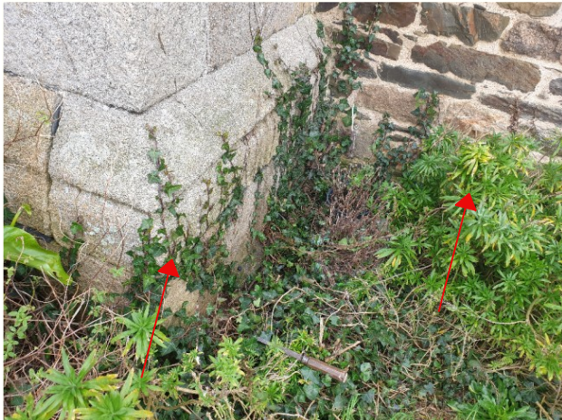
Élévation ouest - Colonisation végétale en pieds de mur
