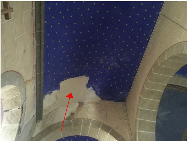
Bas-côté sud - Reprise importante et humidité
