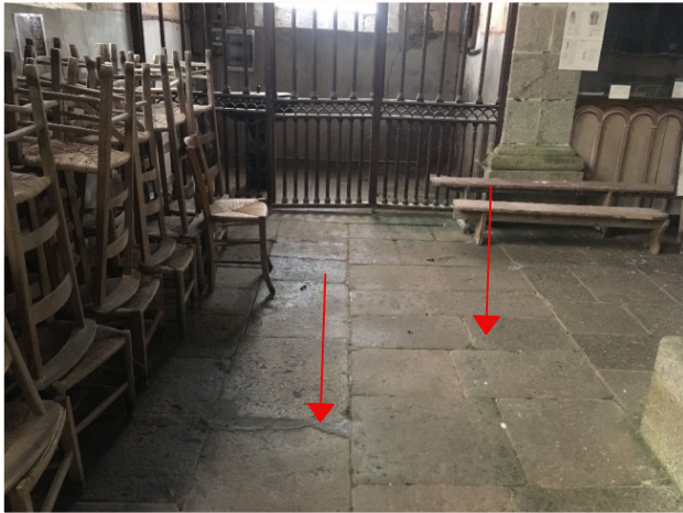
Bas-côté sud - Joints creux ou durs (ciment ?)
