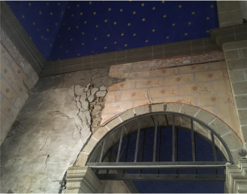
Zone de chute d'enduit et de fissuration avec cintre dans le transept sud
