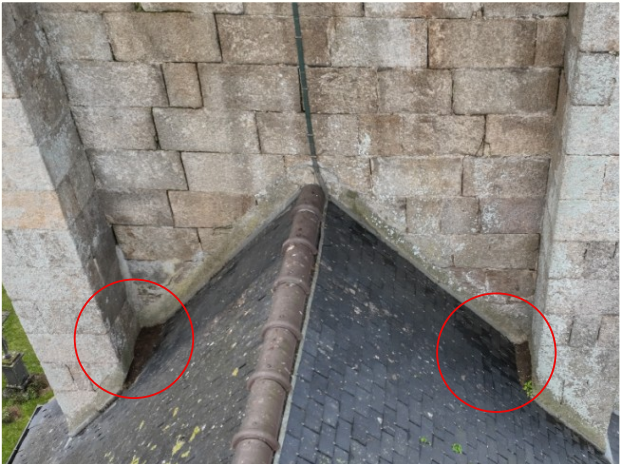
Clocher - Encrassement, rétention d'eau, zone d'infiltration
