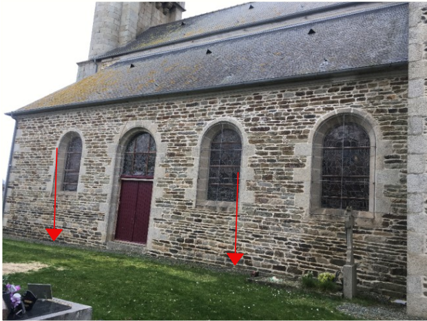
Élévation sud - Humidité en pied de mur
