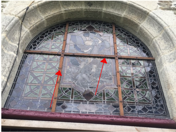
P03 - Oxydation des barlotières
