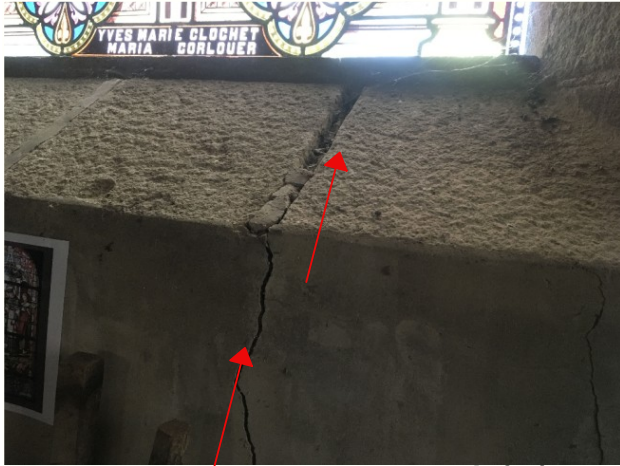
B04 - Fissuration et joint creux sur appui de fenêtre
