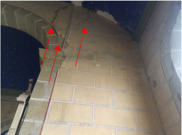
Bas-côté nord - Fissurations et chute d'enduit
