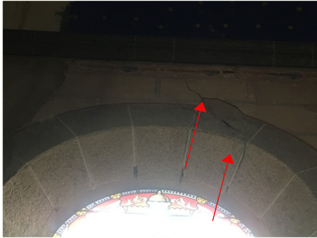
B06 - Fissuration en contact de la baie
