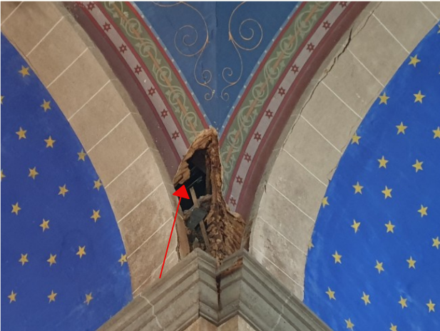
Croisée du transept - Chute importante de voute
