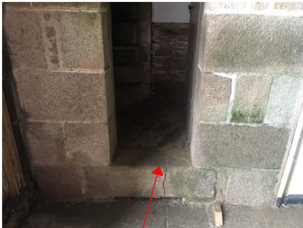
P04 - Fissuration du seuil de porte
