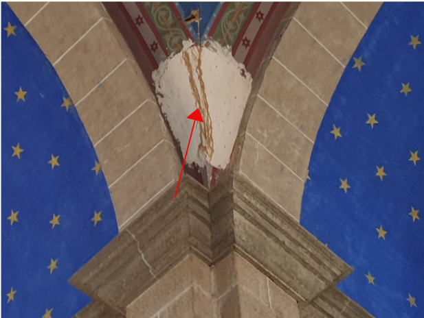
Croisée du transept - Reprise après chute
