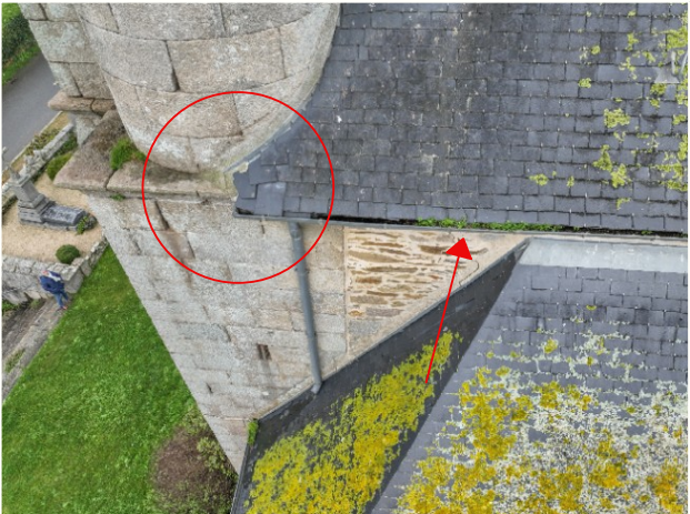
Élévation sud - Gouttière bouchée
