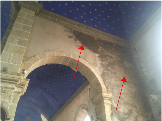
Transept nord - Enduit endommagé avec humidité
