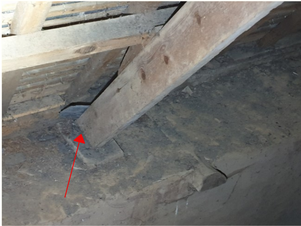
Transept sud - réparation pied arbalétrier, mise en oeuvre inadaptée
