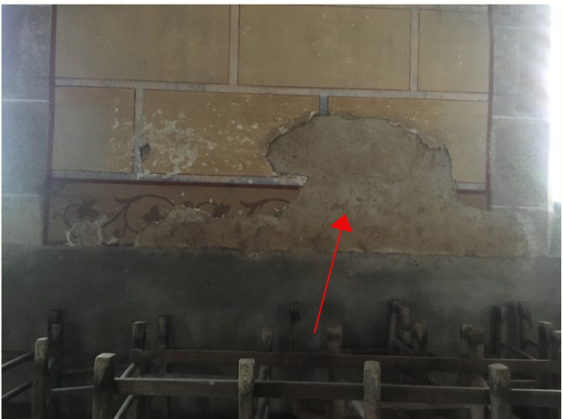
Bas-côté nord - Chute d'enduit
