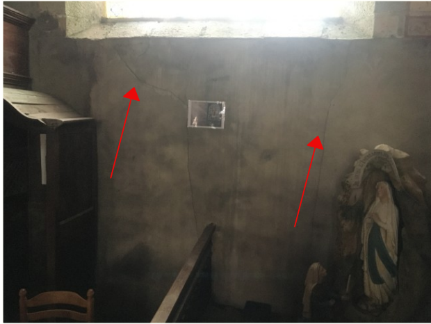
B03 - Fissuration sur enduit en contact de la baie
