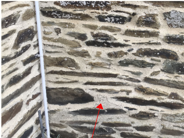
Élévation sud - Eclatement des enduits
