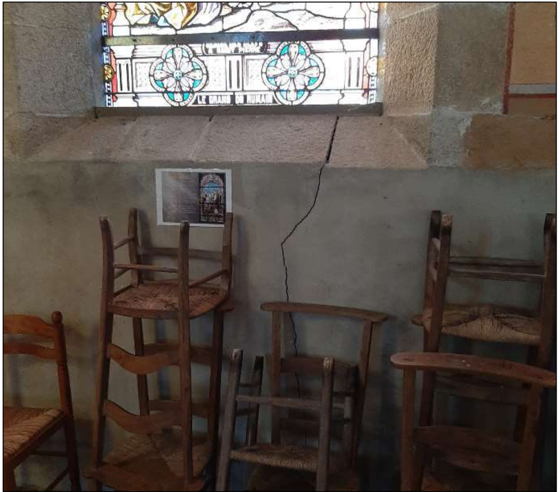
Bas-côté Sud – Fissuration subverticale – 2020-12-17
