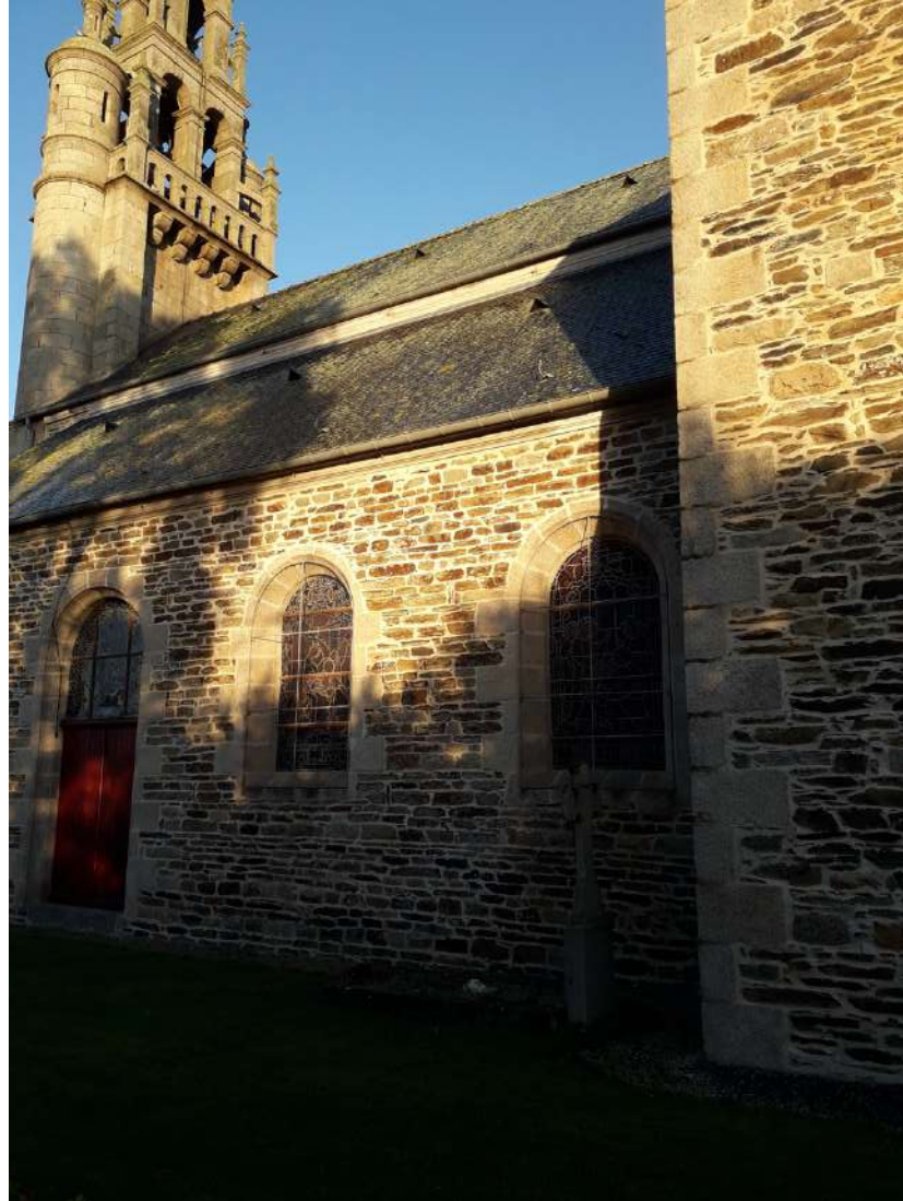
Façade Sud : couverture : présence des lichens et mousses, corniche en bois dégradées et décolorée, Maçonnerie : présence des zones humides notamment en pied, et sous les zones sensibles.
