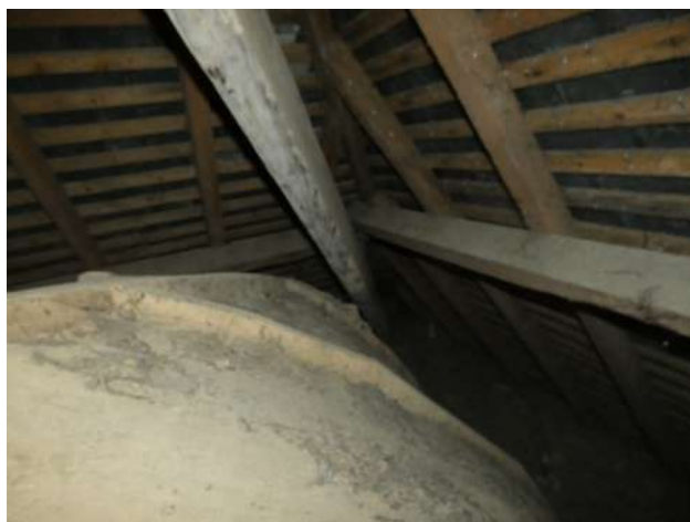
Vue de l'arrêtier et panne faitière filante le long du gouttereau reposant sur des corbelets en bois.
