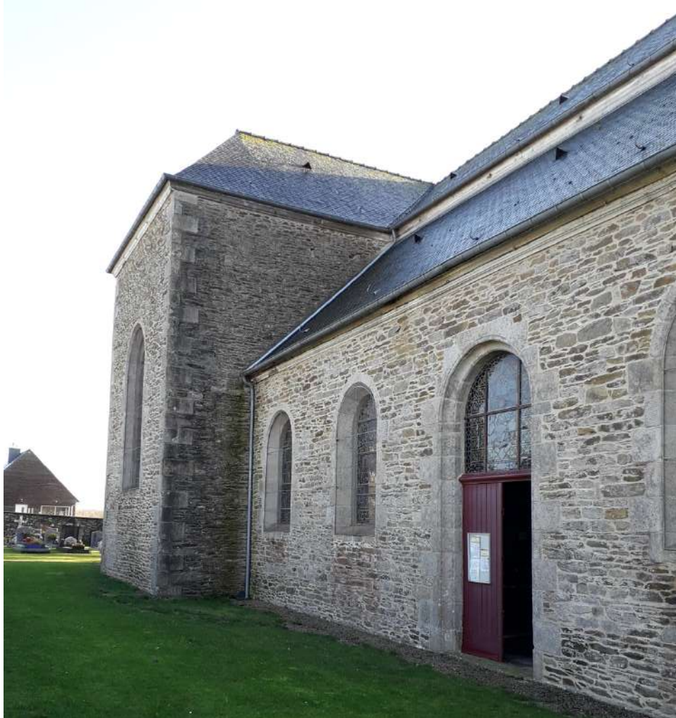
Façade Nord : vue donnant sur bras nord du transept : constatations du même phénomène décrit dans la page précédente pour le bras sud du transept.
