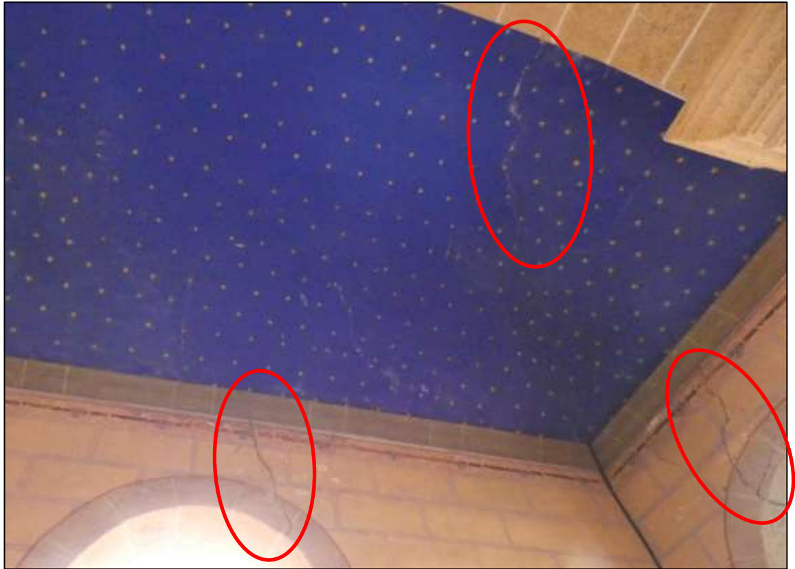
Fissurations sur bas-côté Sud, côté Ouest, à l'approche du clocher – 2020-12-17
