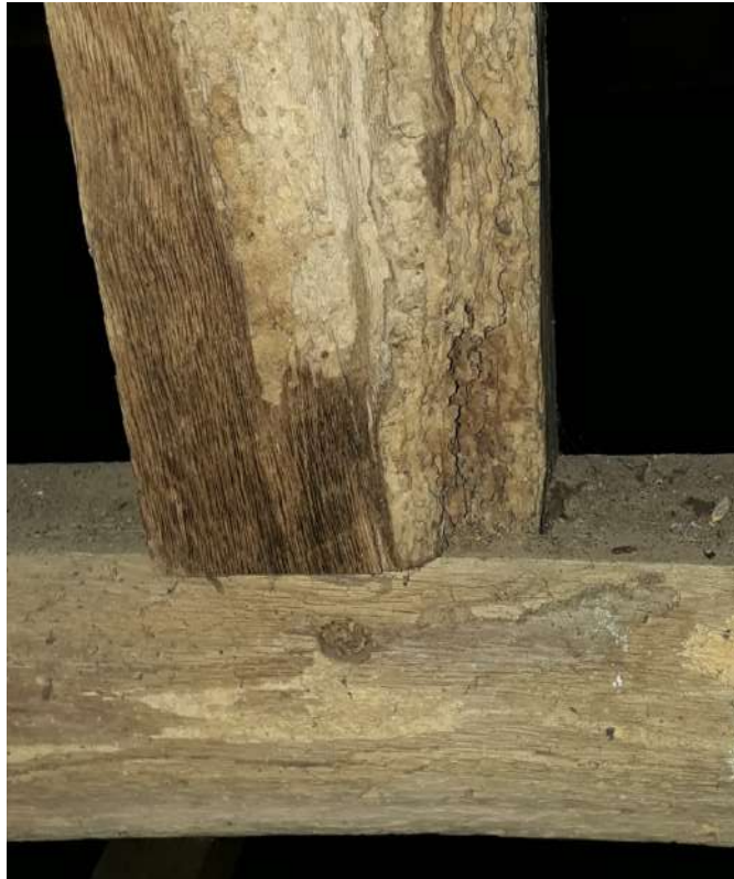
Charpente : Bois pourris dans les zones sensibles.
