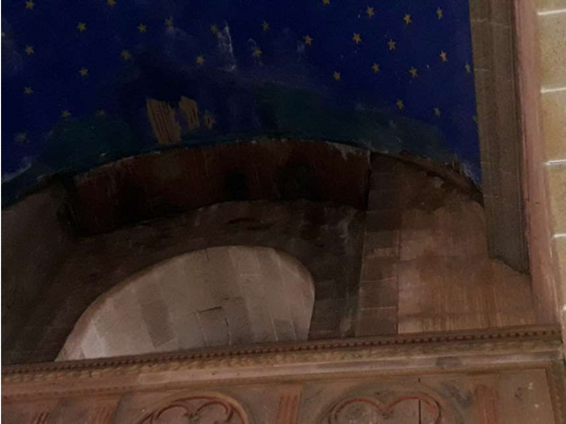
Vue sur pignon ouest : traces d'infiltrations d'eaux de pluies provenant des bandes solins entre toiture nef et tour clocher.
