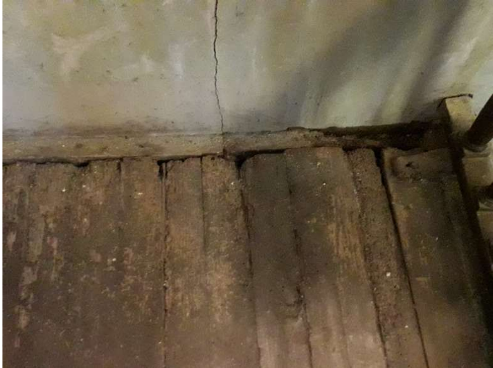
Parquet sur lambourdes : pourris le long des murs.
