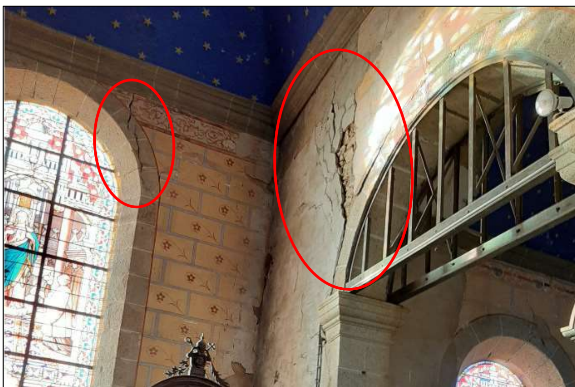
Fissuration oblique et décollement d'enduit à l'angle du transept et du bas-côté Sud – 2020-12-17
