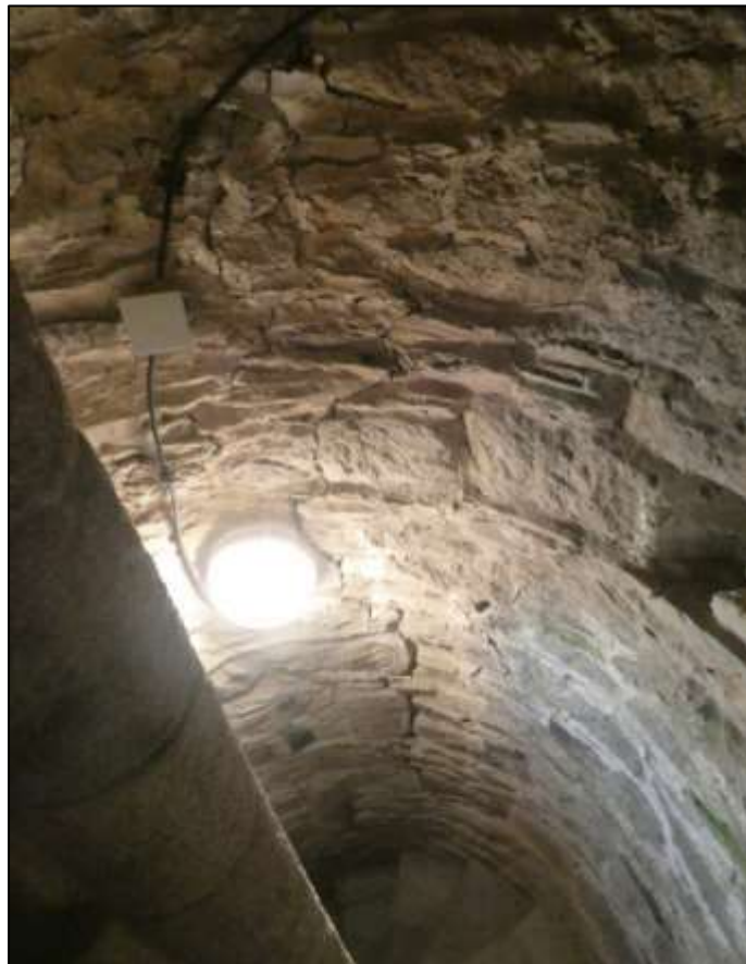
Fissuration subverticale au niveau de l'escalier d'accès au clocher – 2020-02-26
