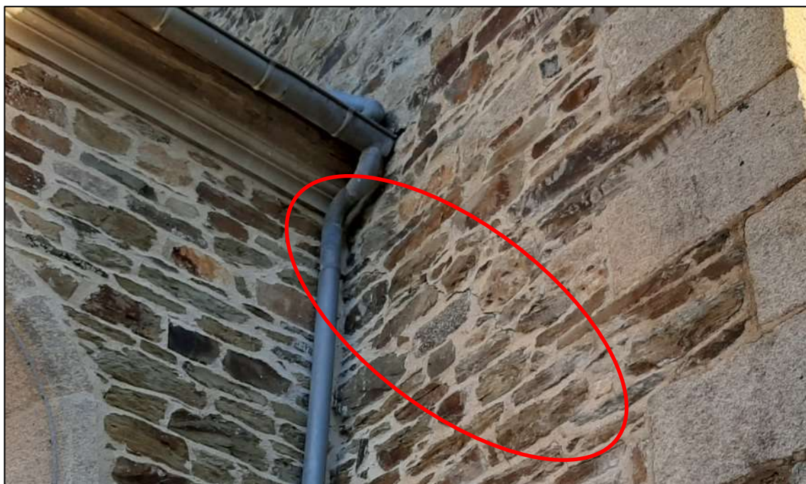
Fissuration oblique à l'angle du transept et du bas-côté Sud – 2020-12-17
