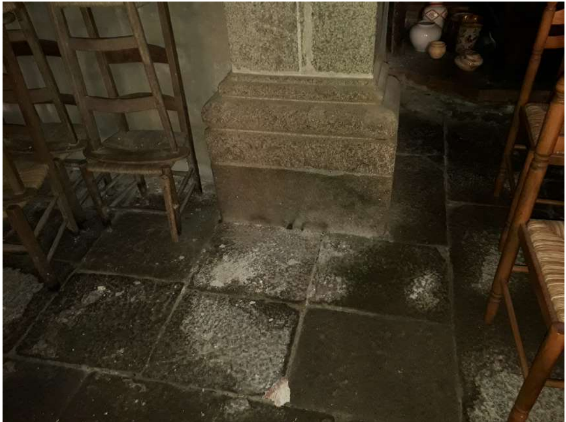
Revêtement de sol : traces d'humidité et salpêtre.
